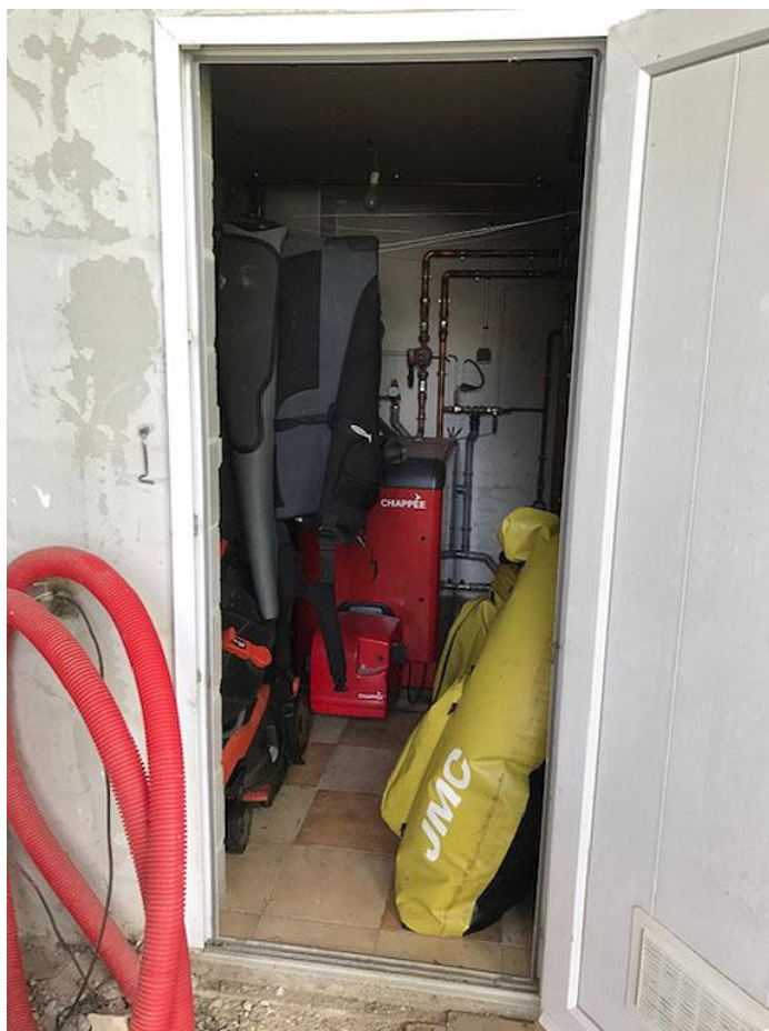
Dans la chaufferie, présence d'une chaudière au fioul ainsi que d'un système de production d'eau-chaude.
